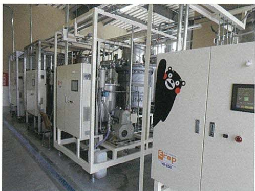
4機ある減圧蒸留装置 1日約3,000リットルのBDFが生産可能に
